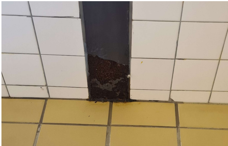
Figuur 5: Corrosie staalconstructie
