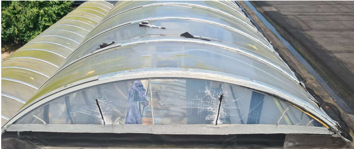
Figuur 2: Beschadigingen en scheuren dakkap.
