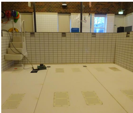
Slechte wand 1, holle tegels
