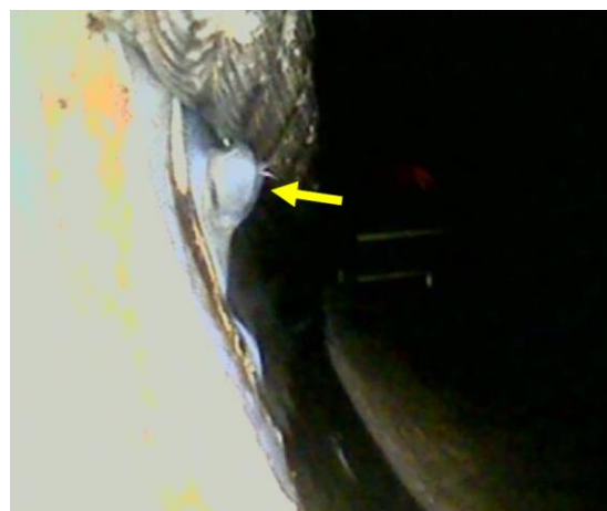
Lekkage in doorvoer (foto Triton)
