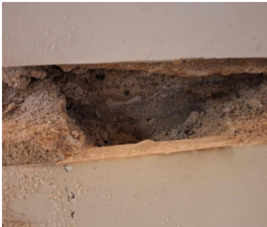
Poreus voegwerk t.p.v. holle tegels
