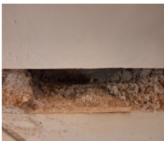
Destructief onderzoek, holle tegels
