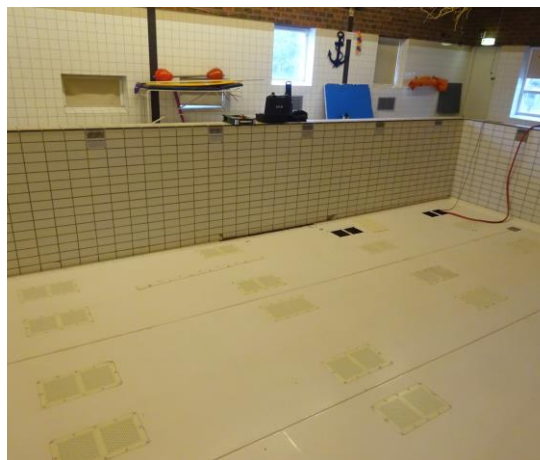
Slechte wand 2, holle tegels
