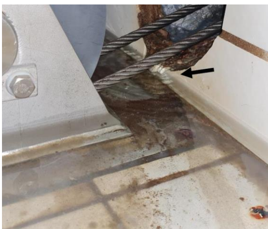
Lekkage in doorvoer (foto Triton)
