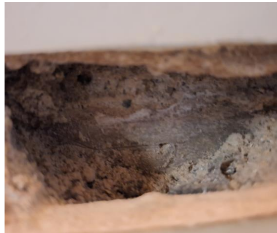
Betonwerk intact t.p.v. holle tegels
