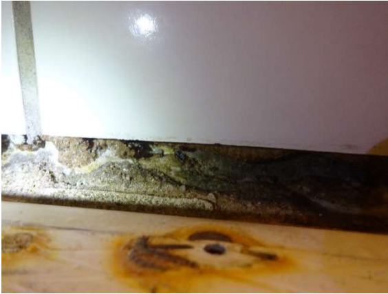
Verweerd en uitgespoeld voegwerk lintvoeg
