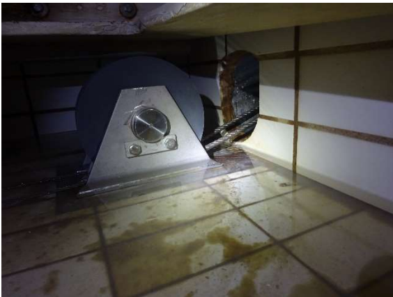
Instromend water bij noordwestelijke doorvoer
